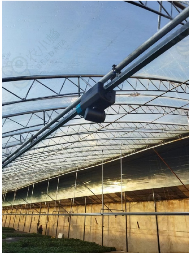
蒙源基地 AI 育苗系统移动巡检机器人
